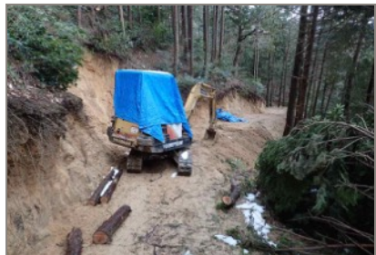
迂回路掘削開始するもエンジン故障
