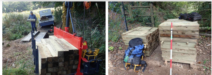
南尾根 林道破損のため途中で積み替え。資材置場からは歩荷 21日、26日
